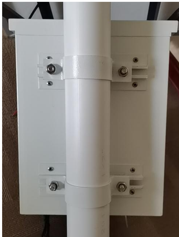
安装完成背面图
